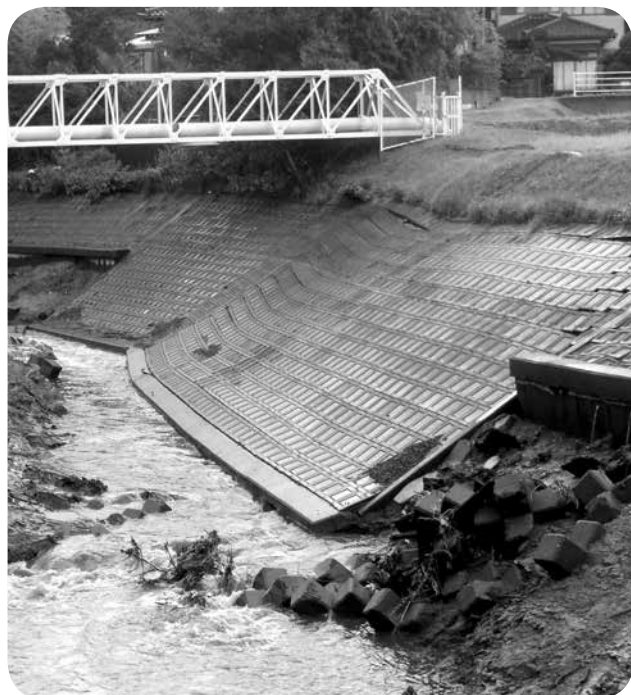
大雨による災害か所 (大上)
